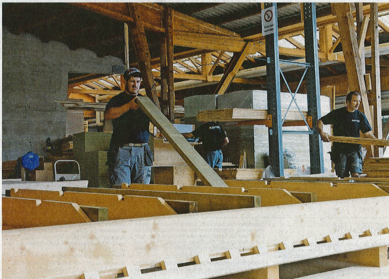
Ruedi Käslin (links) prüft in der Produktionsstrasse die Balken, bevor sie in die Lärmschutzwand eingebaut werden. Bild Philipp Unterschütz
