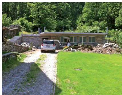
Il terreno edile con il seminterrato prima del montaggio della struttura in legno
