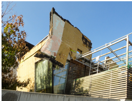
Vorderansicht des abgebrannten Gebäudes
