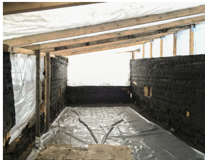
Innenansicht des abgebrannten Daches
