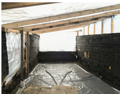
Vista interna del tetto bruciato
