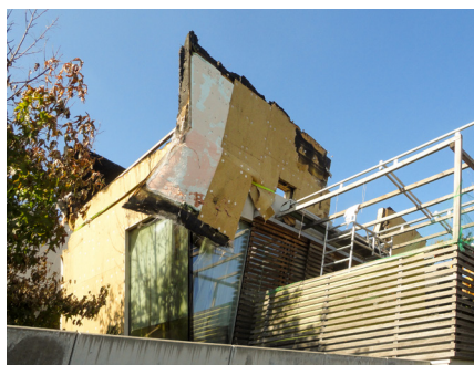
Vista frontale edificio bruciato
